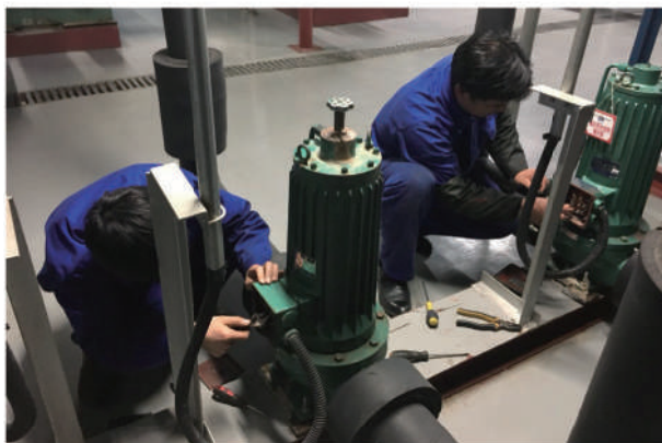
恒有源集团国家行政学院项目机房值守员工正在为设备进行检修、调试
