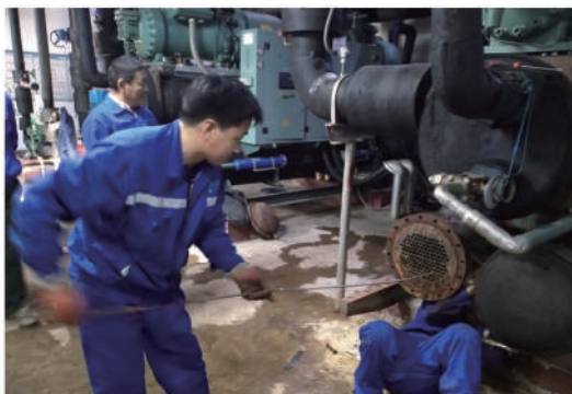
恒有源集团机房值守员工对设备进行检修
